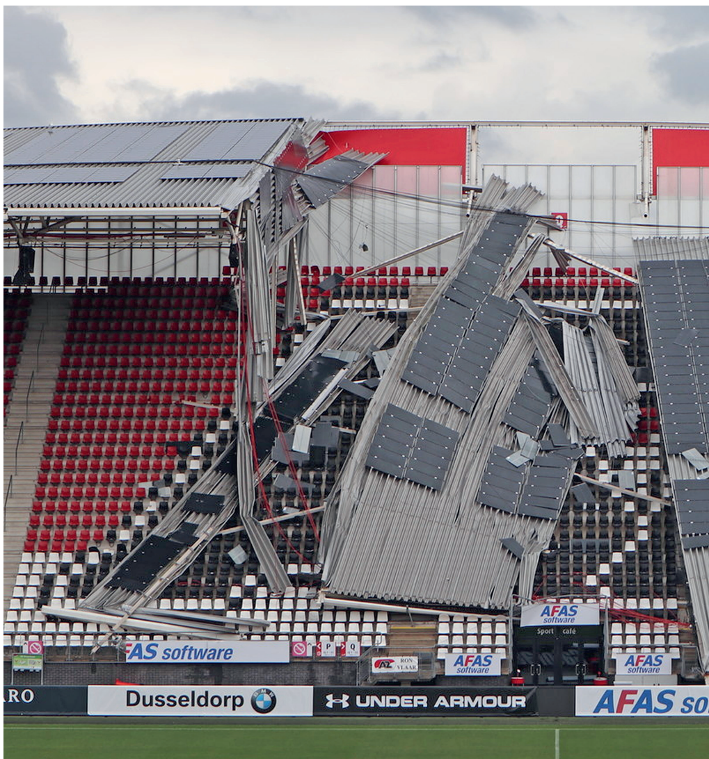
De instorting van een deel van het dak van het AZ-stadion was aanleiding voor de ontwikkeling van NTA 8790.
